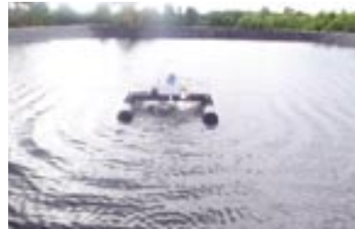
Figura 4.2-24 Arejadores de superfície "tipo ondulamento"
