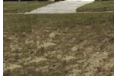
Figura 4.2-18 Processo erosivo em margem de lago
